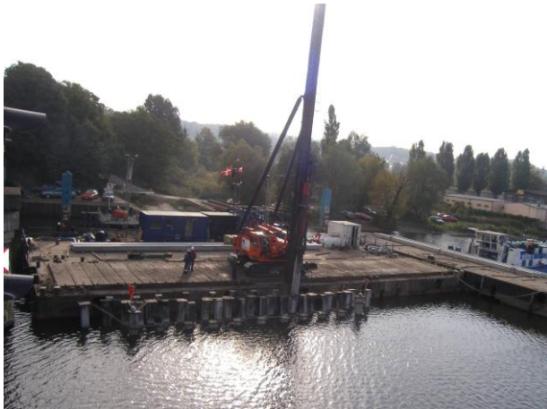
Fot. 5. Fundament filara mostu drogowego przez Regalicę w ciągu ul. Autostrada Poznańska w Szczecinie – przykład palowania „z wody”
