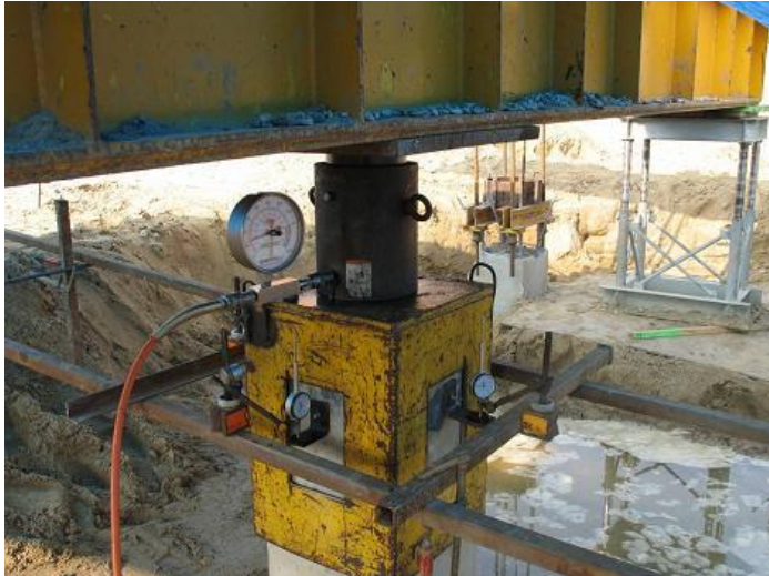
Fot. 18. Układ obciążenia (siłownik hydrauliczny) oraz układ pomiarowy (czujniki zegarowe) w trakcie próbnego obciążenia statycznego
