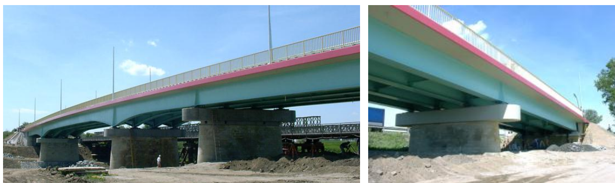
Fot. 4. Stare podpory nowego mostu przez San w Radymnie – w fundamentach wykorzystano istniejące studnie i pale prefabrykowane
